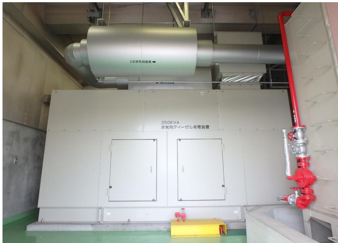
印東加圧ポンプ場自家用発電機設備(平成 27 年 2 月完成)
