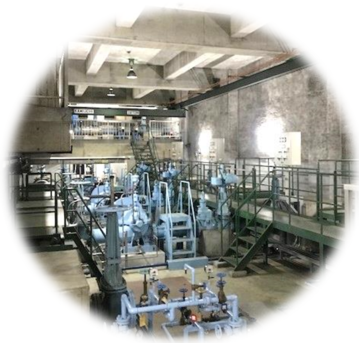
印東加圧ポンプ場の 送水ポンプ設備
